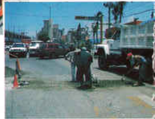
Cableado subterráneo, Zona Dorada
