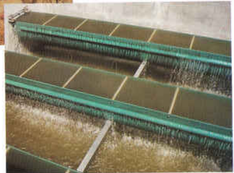
Proceso de filtración
