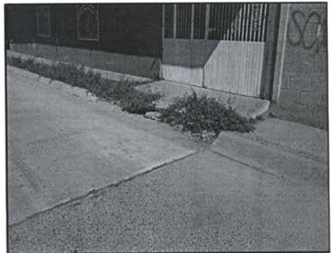
Foto 17. Pavimento calle Alvaro Obregon esquina izquierda casi esquina con calle Lombardo Toledano.
