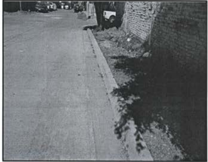
Foto 7. Pavimento de calle Alvaro obregon tramo Felipe angeles y Vicente Lombardo Toledano.
