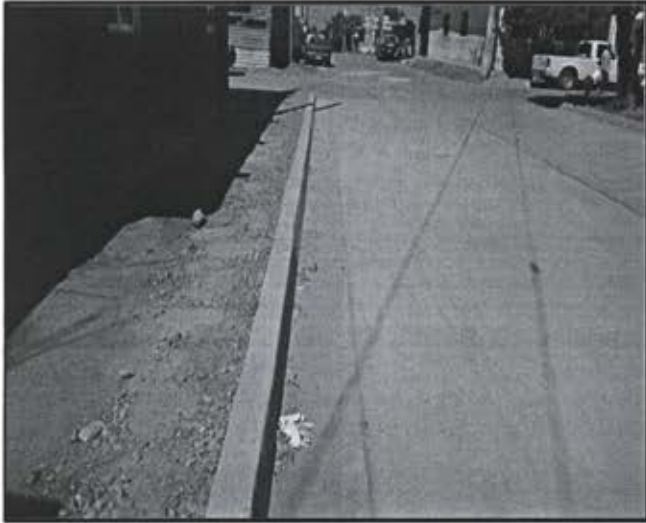
Foto 6. Pavimento de calle Alvaro obregon tramo Felipe angeles y Vicente Lombardo Toledano.
