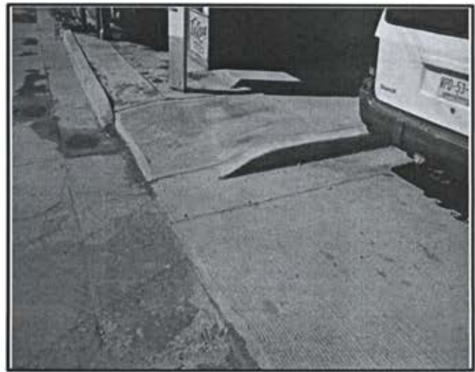
Foto 9. Pavimento calle Alvaro Obregon esquina derecha, cruce calle Vicente Lombardo Toledano
