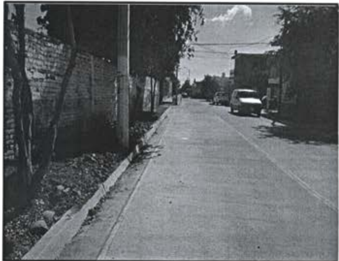
Foto 5. Pavimento de calle Alvaro obregon tramo Felipe angeles y Vicente Lombardo Toledano.
