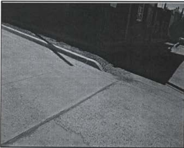
Foto 4. Pavimento calle Alvaro Obregon esquina derecha con cruce calle Felipe Angeles
