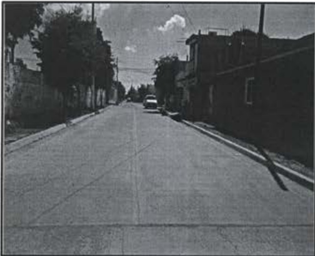
Foto 2. Pavimento de calle Alvaro Obregon vista desde cruce con calle Felipe Angeles.
