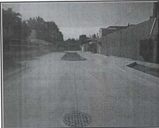
Foto 2. Pavimento de calle Rio Presidio
