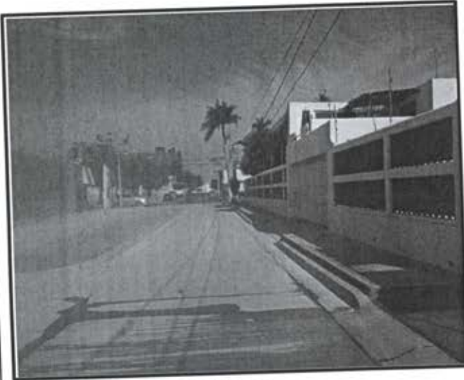
Foto 14. Pavimento de calle Rio Presidio
