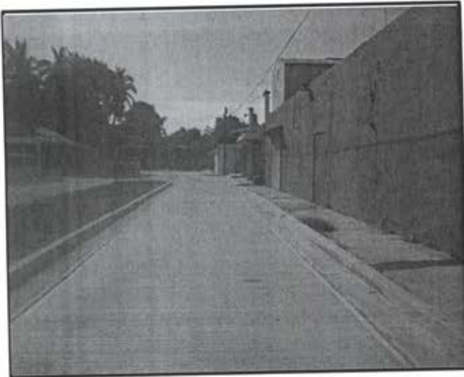
Foto 6. Pavimento de calle Rio Presidio
