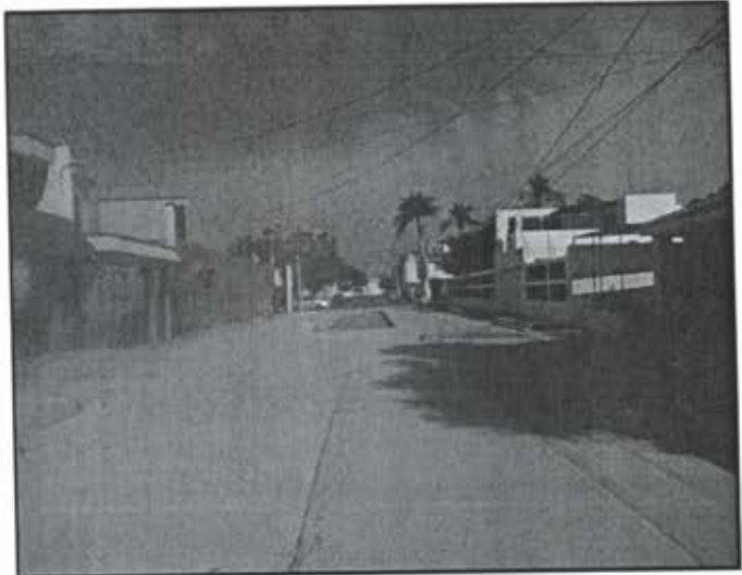
Foto 7. Pavimento de calle Rio Presidio
