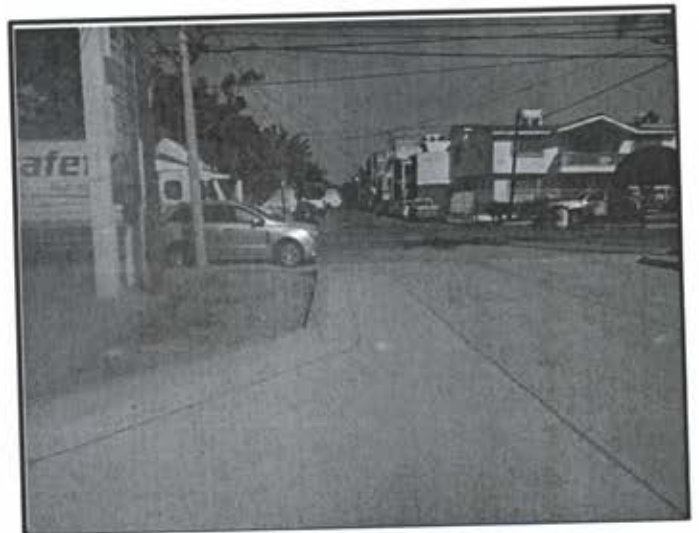
Foto 17. Pavimento de calle Rio Presidio
