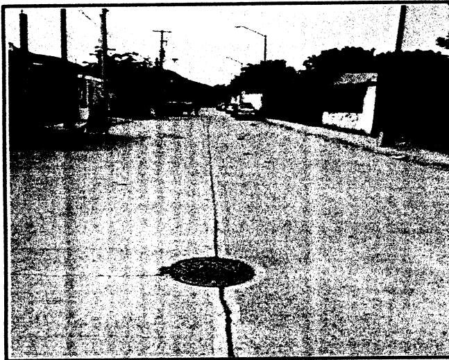
Foto 8. Pavimentación de calle Atardecer entre calle Relámpago y calle Nube, col. Villas del Sol.
