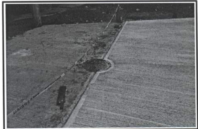
9.- Terminacion de tramo pavimentado en calle Tomas Urbina esquina con calle Plan de Ayala, Colonia Francisco Villa.
