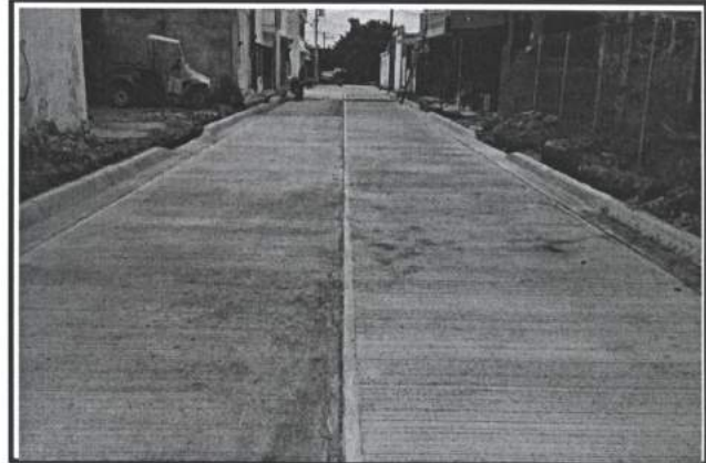
3.- Pavimento de concreto premezclado F'C= 250 kg/cm2 de 15 cm de espesor, Calle Tomas Urbina.
