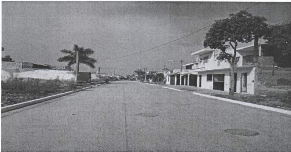
Foto 1. Pavimentación calle Mariano Abasolo entre C. Francisco I. Madero y calle 2 de Abril, col. Burocratas.
