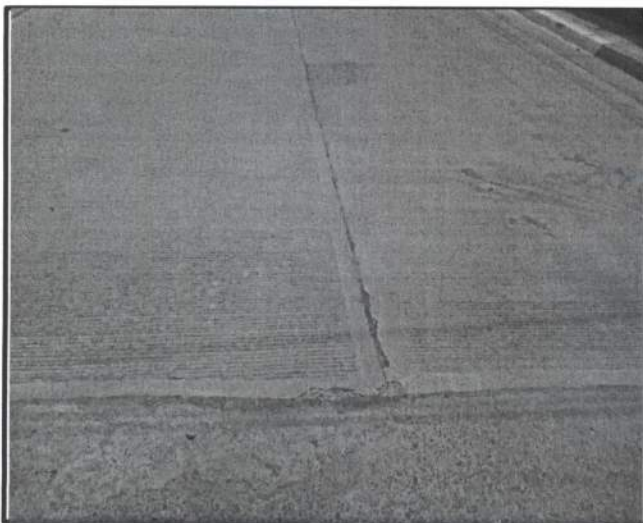
Foto 4. PAVIMENTO C. CONSTITUCION DE 1917 CRUCE CALLE MARGARITA MAZA DE JUAREZ
