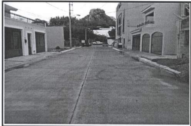
11.- Pavimento en Calle Playa Copa Cabana
