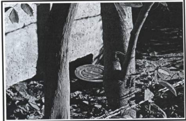
11.- Bota de Fierro fundido y Llave de banqueta en medidor.
