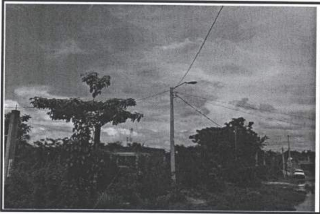
6.- Alimentacion Electrica a Carcamo Colonia Nuevo Milenio.
