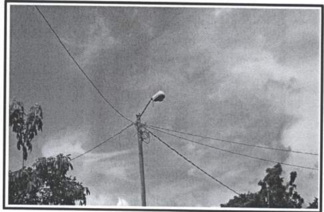
7.- Alimentacion Electrica a Carcamo Colonia Nuevo Milenio.
